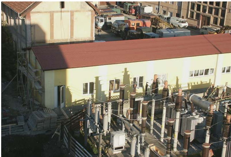
Felújított külsőtéri alállomás
