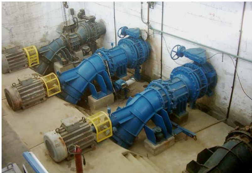
A Gát vízerőmű gépháza
