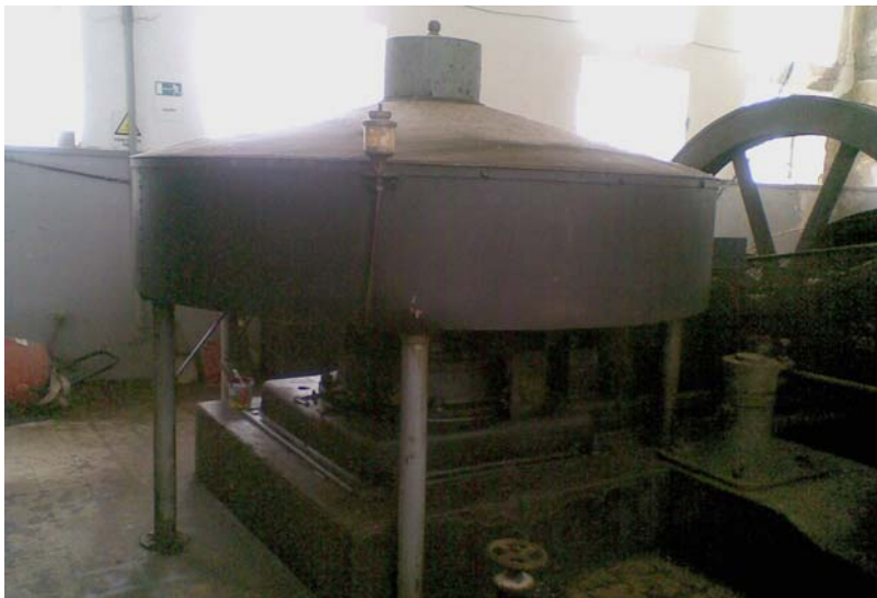
A turbineszabályzó berendezése
