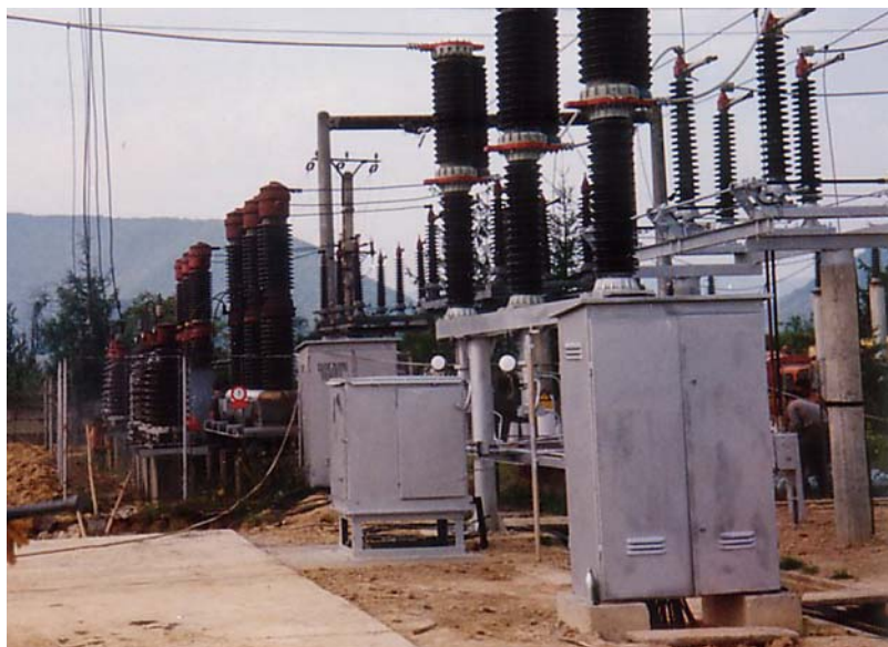
A felújított 110 kV-os alállomás részlete
