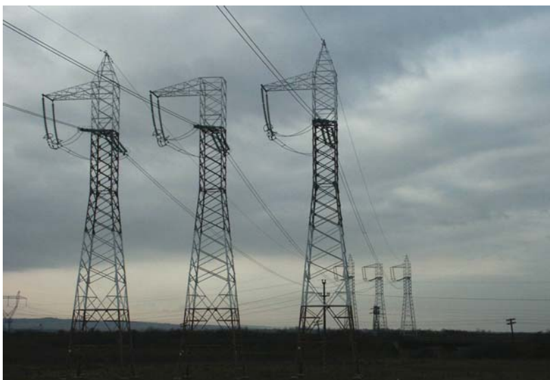
Modern 400 kV-os távvezeték tartóoszlopai
