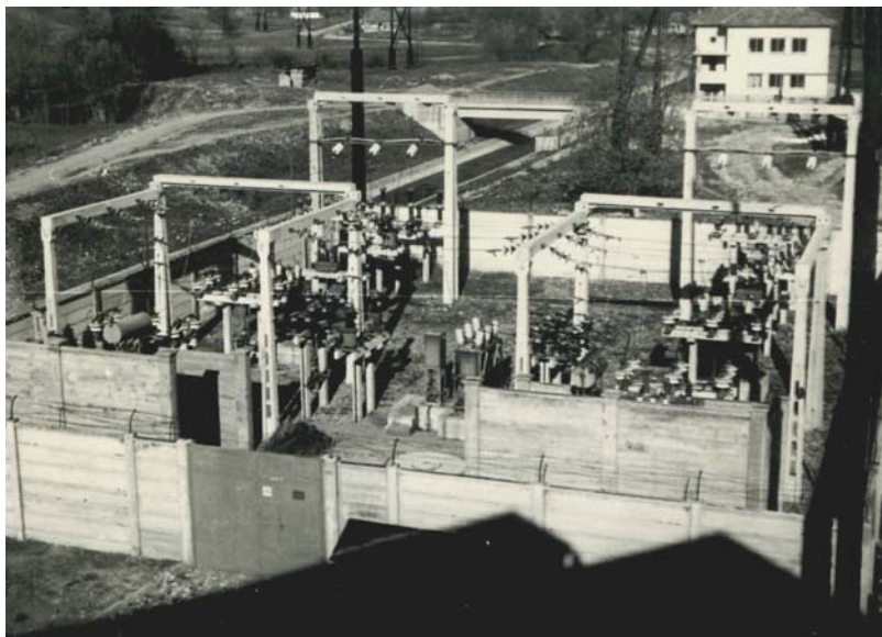
Külsőtéri 36 kV-os alállomás, hátul az erőmű épülete
